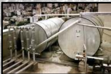
Isolamento térmico em caixa d'água de sistema de coletor solar
