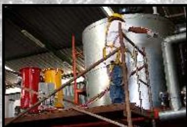
Isolamento térmico em instalações industriais
